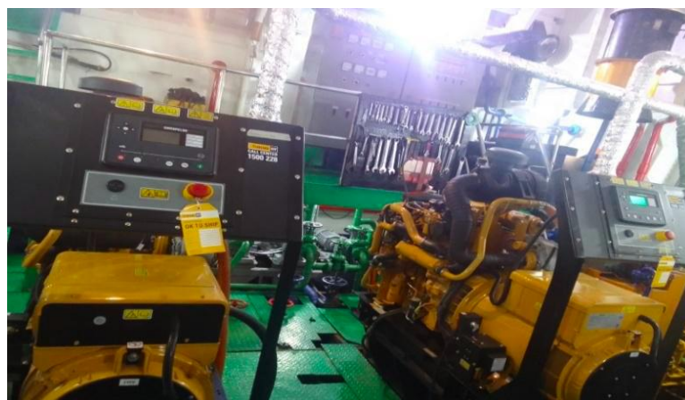
Gambar 3. Generator Listrik Kapal Pengawas Perikanan
